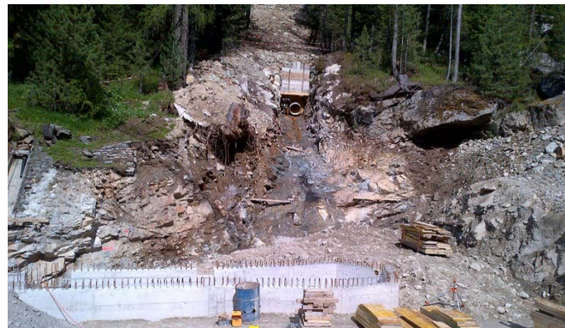
Cantiere della Centrale Morteratsch: condotta forzata (secondo piano) e canale di restituzione/centrale (primo piano)
