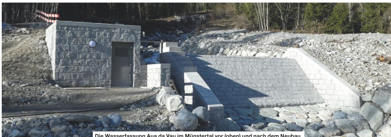
Die Wasserfassung Aua da Vau im Münstertal vor (oben) und nach dem Neubau.
